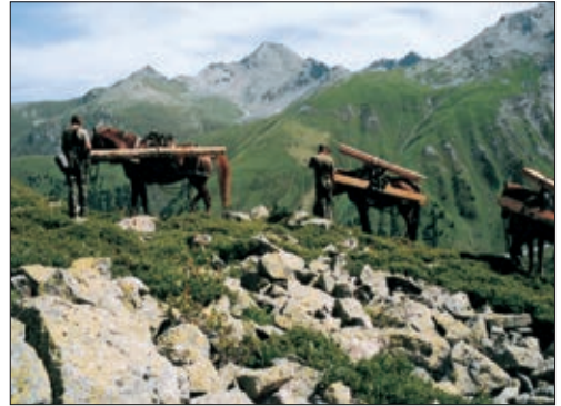
Trainsoldaten verrichten ein gutes Werk: Sie transportierten das Holz fürs neue Dach.
