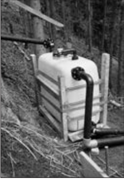
2000 Liter – Tank: Provisorium während der Bauzeit im Sommer 2003
